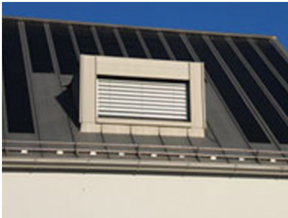
Integrierte Photovoltaik-Anlage, die Module verschmelzen mit der Dachhaut zu einer Einheit.
